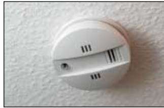
Rauchmelder gab Alarm.
