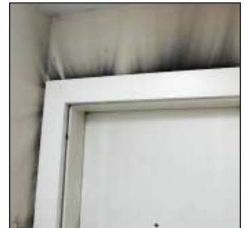
Aus der Nachbarwohnung drang Rauch.
